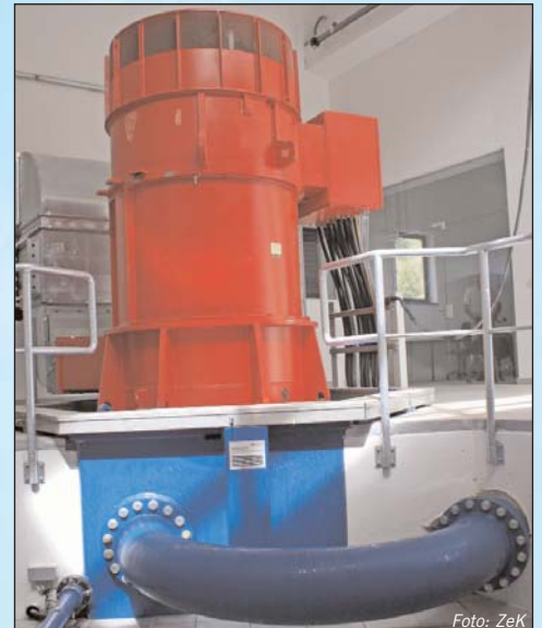
Aus vier Düsen kommt der Antrieb für das Laufrad. 1,9 Megawatt leistet die neue Pelton turbine
