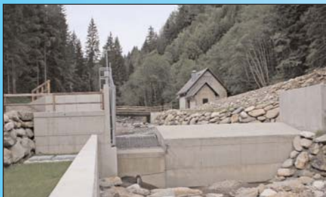
Wasserfassung: Klassisches Tirolerwehr
